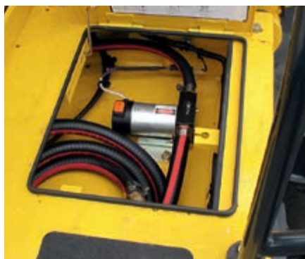
Pompe de réapprovisionnement électrique
