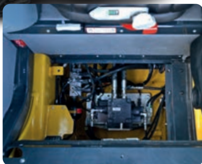
Grazie al cofano all'interno della cabina, la manutenzione straordinaria della valvola principale può essere eseguita rapidamente senza ribaltare la cabina
